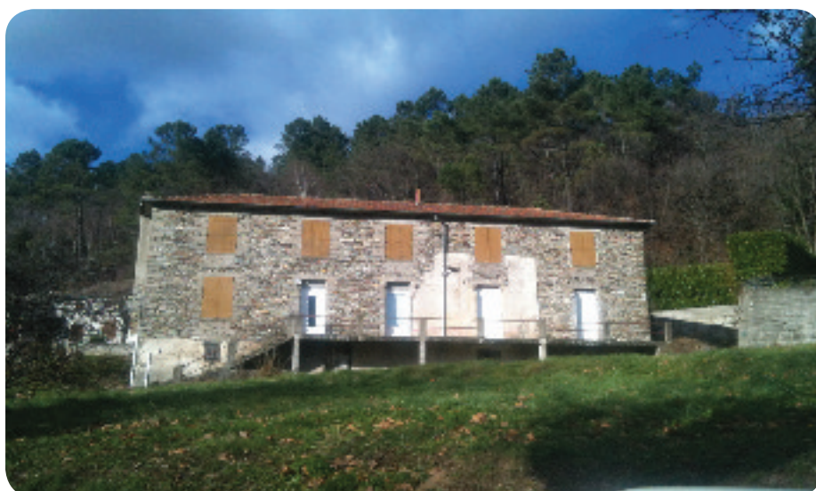
Restauration maladroite, ne respectant pas les matériaux originels
